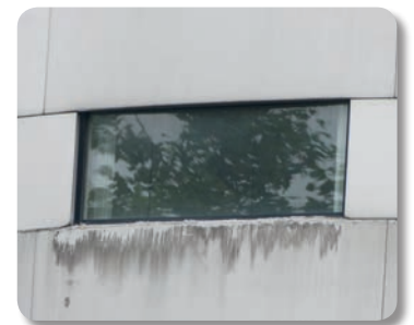
Slecht aangebrachte coating op aluminium
