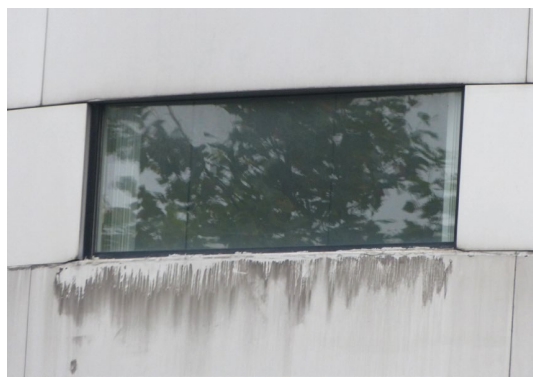
Slecht aangebrachte coating op aluminium
